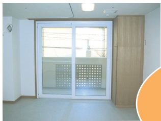
▲全閉施錠状態
